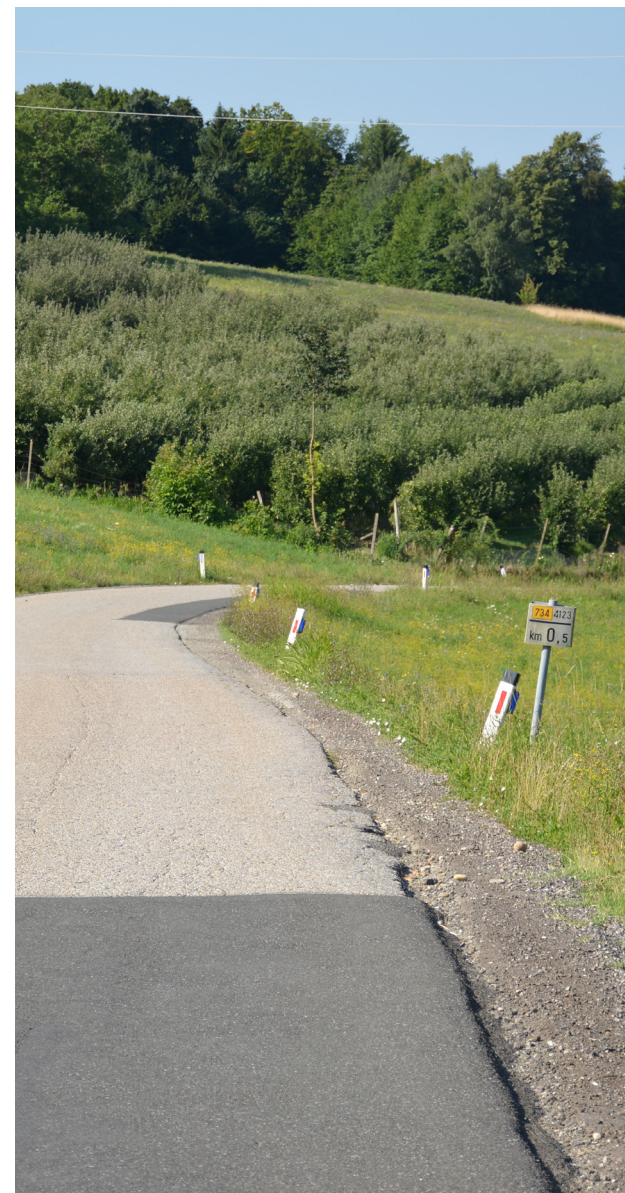
Slika 11: Z aktivnim vzdrževanjem cestnega omrežja bi se izognili prometno nevarnim odsekom z neurejenimi bankinami, ter dotrajanim cestiščem
